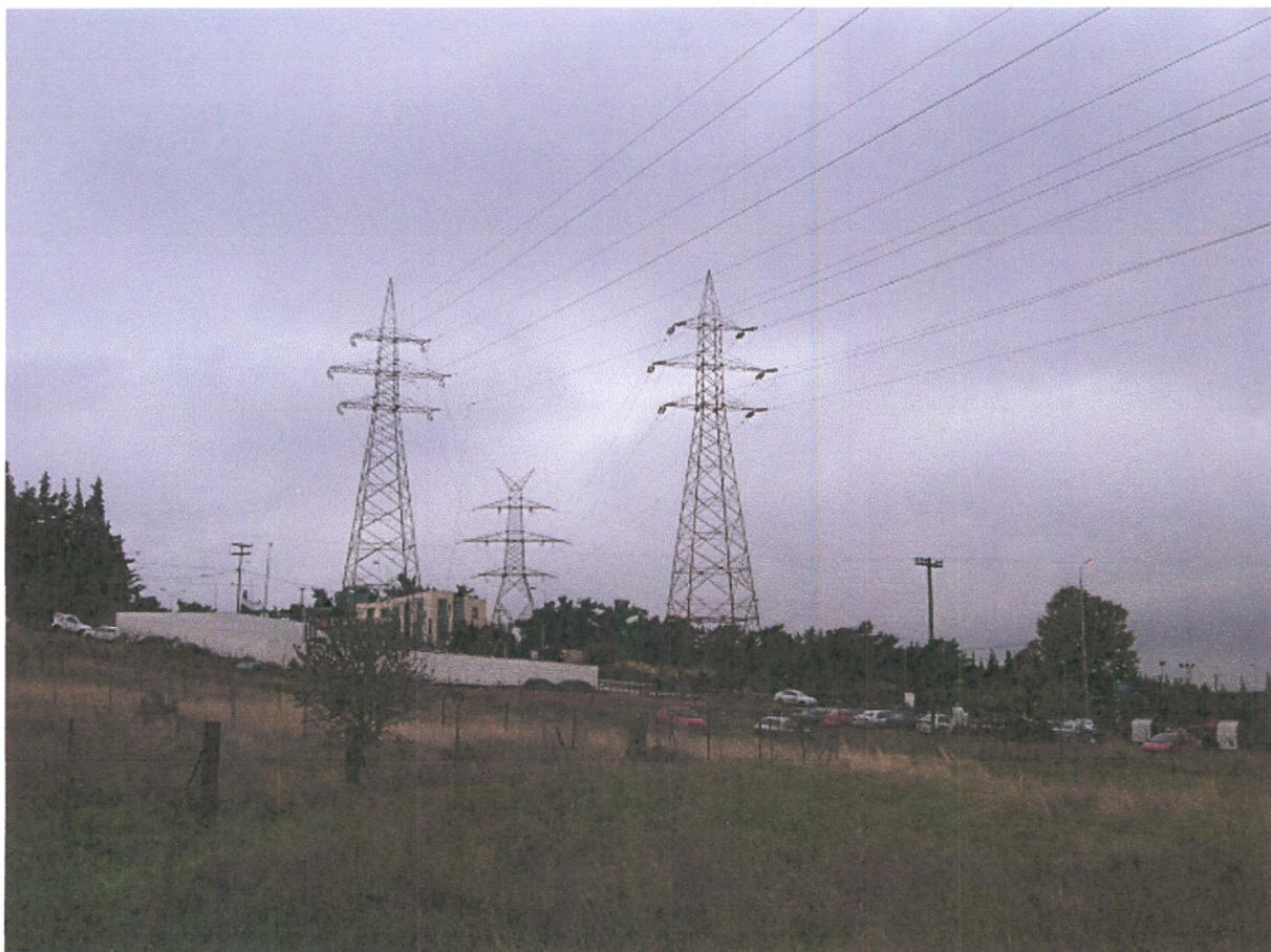
Φωτογραφία 1: Άποψη των γραμμών μεταφοράς 150kV διπλού κυκλώματος πλησίον του Κολεγίου Ανατόλια.
