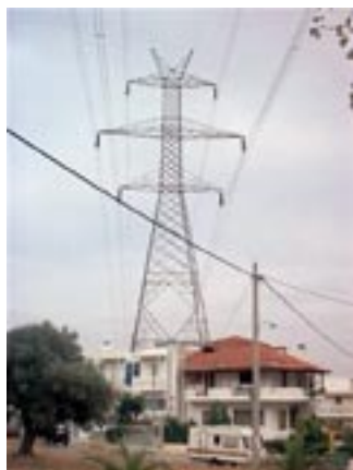
Γραμμές υπερυψηλής τάσης 400kV
