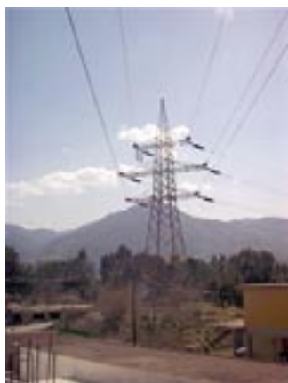
Γραμμές υψηλής τάσης 150kV
